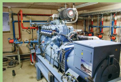
Vue de l'un des moteurs de cogénération (gaz -> électricité et chaleur)
