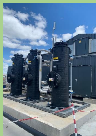
Vue de l'un des éléments de filtration et de purification (gaz provenant des digesteurs -> méthane injecté dans le réseau)
