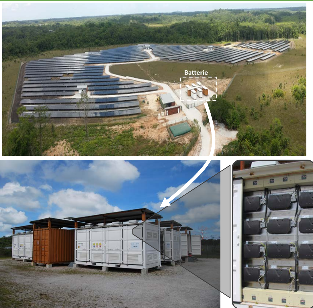
Figure 6 : Centrale photovoltaïque de Toucan équipée d'un système de stockage
