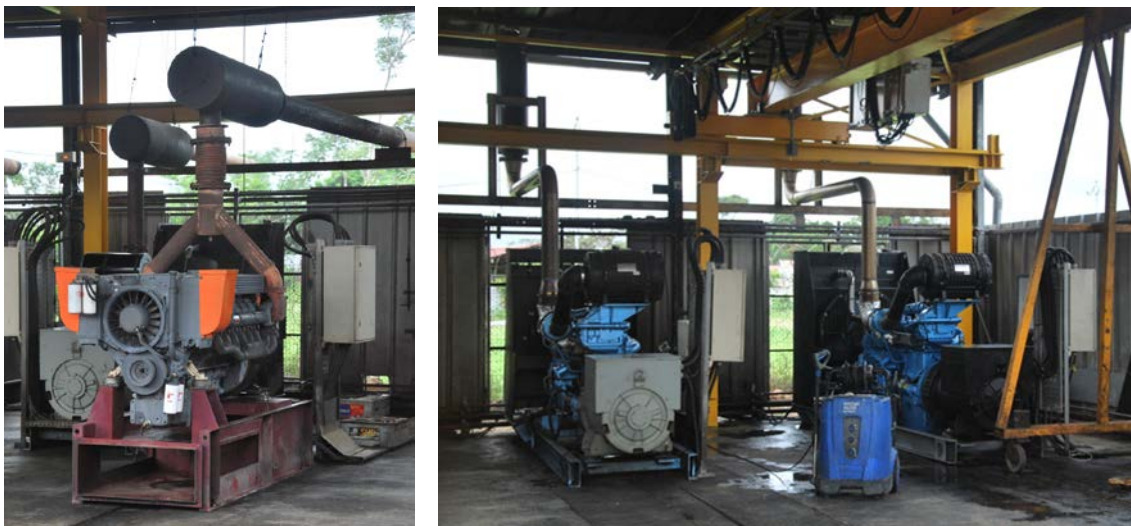
Vue de la salle des machines
