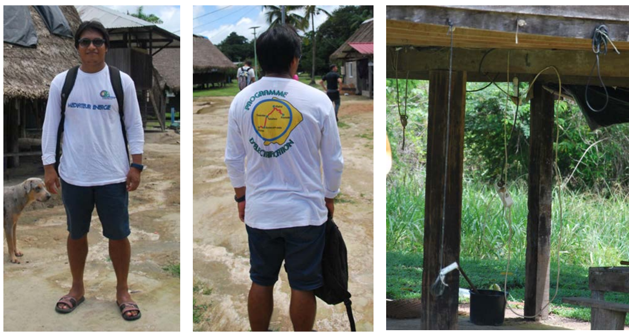
Figure 10 : Médiateur de l'énergie dans les écarts du Haut Maroni et exemple des connexions d'un micro-réseau artisanal de l'écart de Talwen en Haut-Maroni
