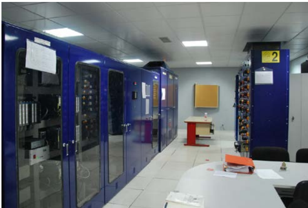
Salle de contrôle commande
