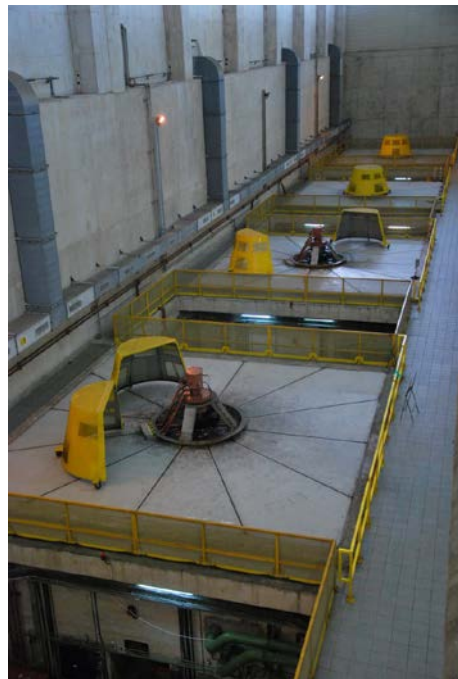
4 groupes blocs de production
